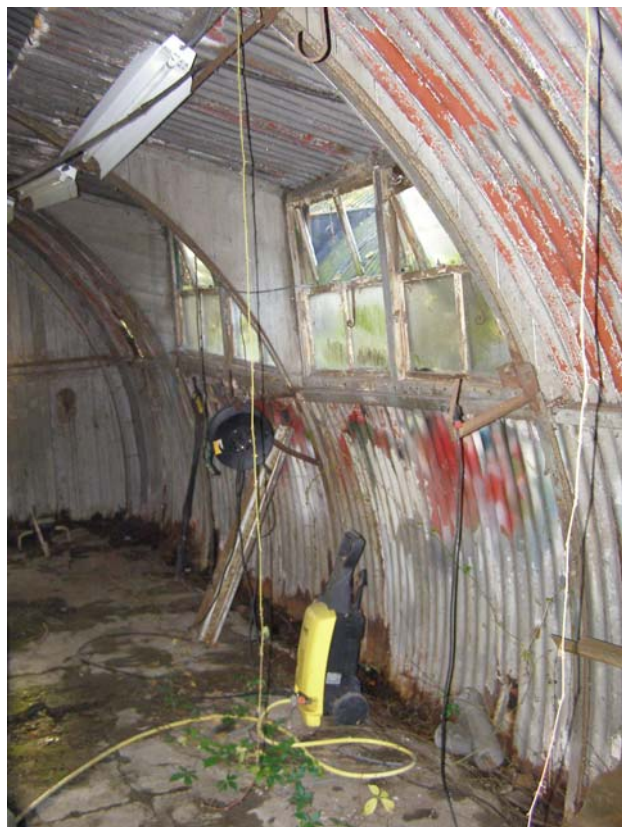
Opstal 3a, verzakkingen
